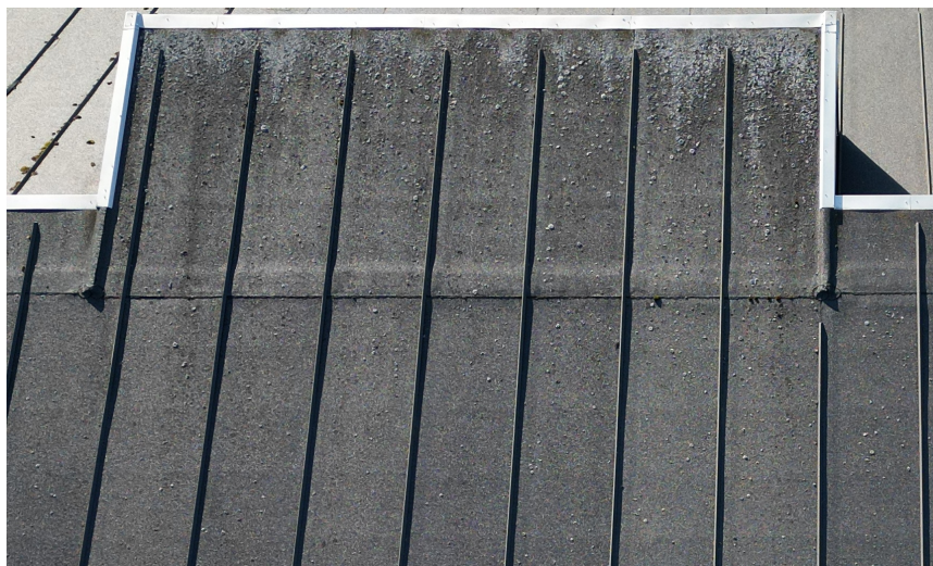
Figur 4.5: Dronebilde av biologisk vekst, og god overlapp i skjøten. Foto: Trondheim kommune.
