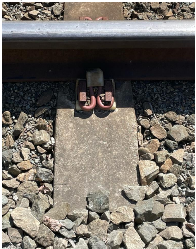
Figur 2-3: Befestigelse på betongsville. Bilde tatt ved Lerkendal.
