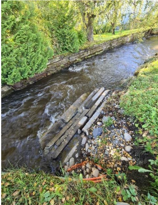
Figur 8. Ved Nyhusvegen 136/28. Deler av en mur rast ut i elva. Av Melhus kommune (2022a).
