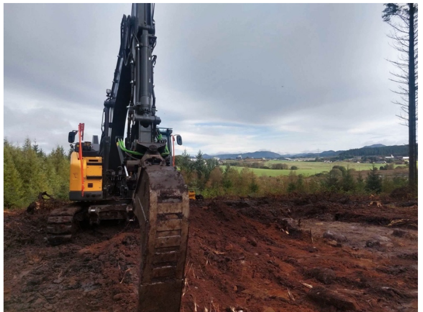
Figur 3: Dieseldrevet gravemaskin fra arkeologisk utgraving. Bruk av elektriske gravemaskiner blir derimot mer og mer vanlig på byggeplasser – kanskje vi vil se denne utviklingen i arkeologiske utgravninger også? Foto: Ingvild Haraldsdatter Johns.
