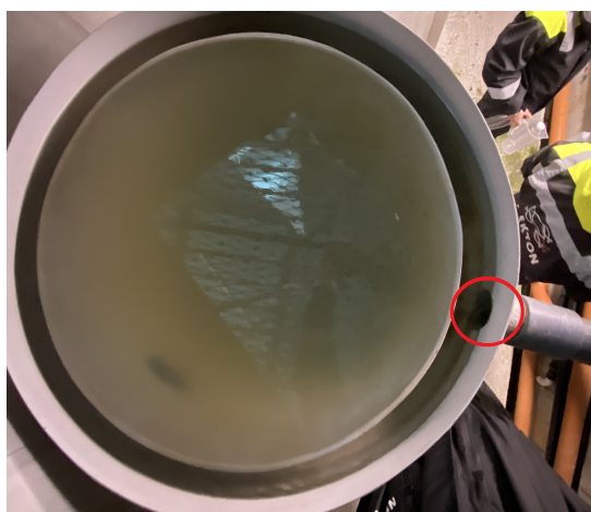
Figur 13: Figuren viser overløpet til syklonen. Innenfor den røde sirkelen finner man åpningen til overløpsrøret, hvor det rensede vannet transporteres bort fra syklonen. Bilde fra: Gruppen
