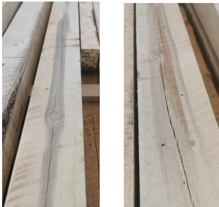
Bilde 3: Råte og brentved av 3A-B, foto: Silje Hoem Johansen
