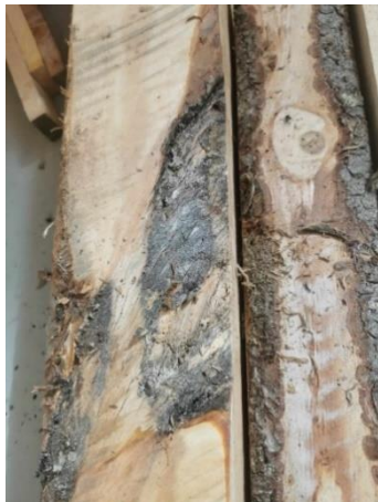
Bilde 11: Råte (overflate) av X-Y, foto: Silje Hoem Johansen
