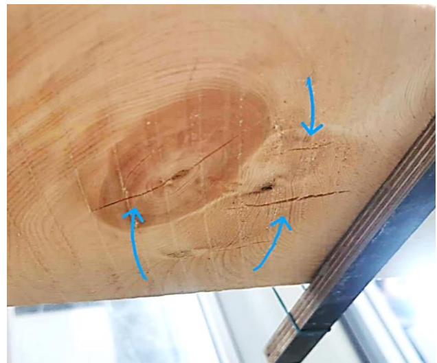
Bilde 24: Sprekker i og rundt kvist etter nedbøyning av 10A-B.3 midten av trevirke, foto: Silje Hoem Johansen
