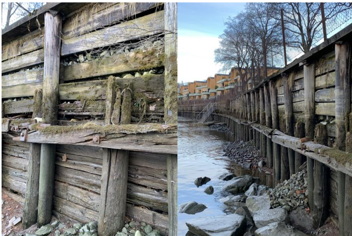
Figur 6: Erosjonssikring i Nidelva ved Baklandet mars 2024. Foto: Aneli Hovland Skaar (2024)
