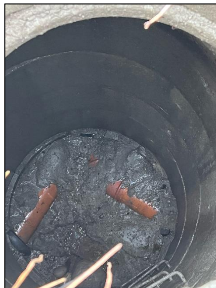
Figur 22 - Eksisterende felleskum 7179, viser skarp retningsendring på ledningsnett. Bilde tatt ved befarings 11.04.2024
