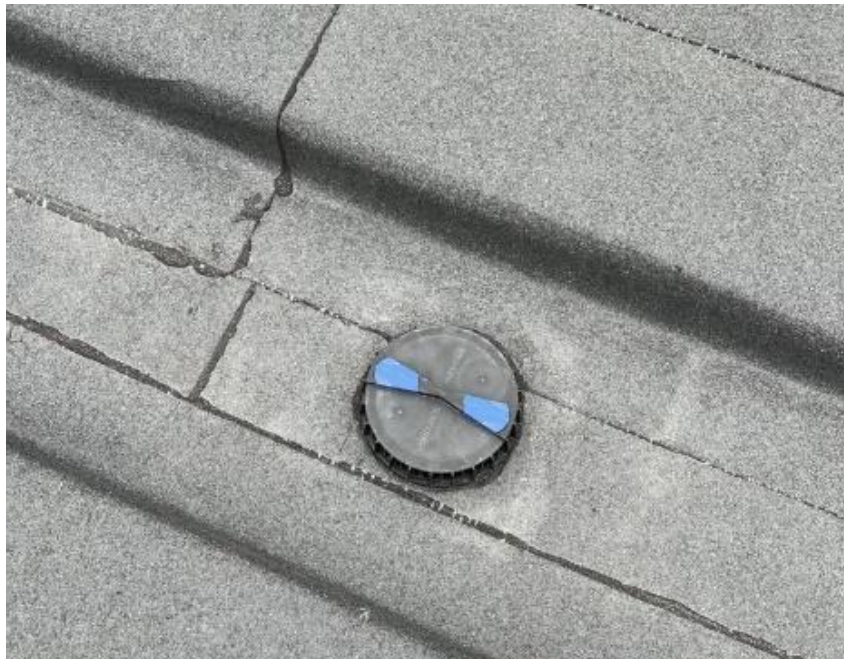
Figur 73: Sluk på taket på Teknostallen. Foto: Privat bilde fra befarings på Teknostallen.
