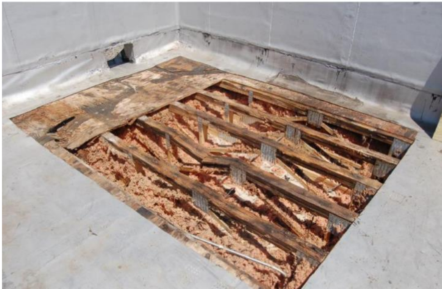
Figur 40: Kompakt tak med bindingsverk av tre utsatt for skade ved uheldig utførelse. Hentet fra: Roofing Magazine. [79]
