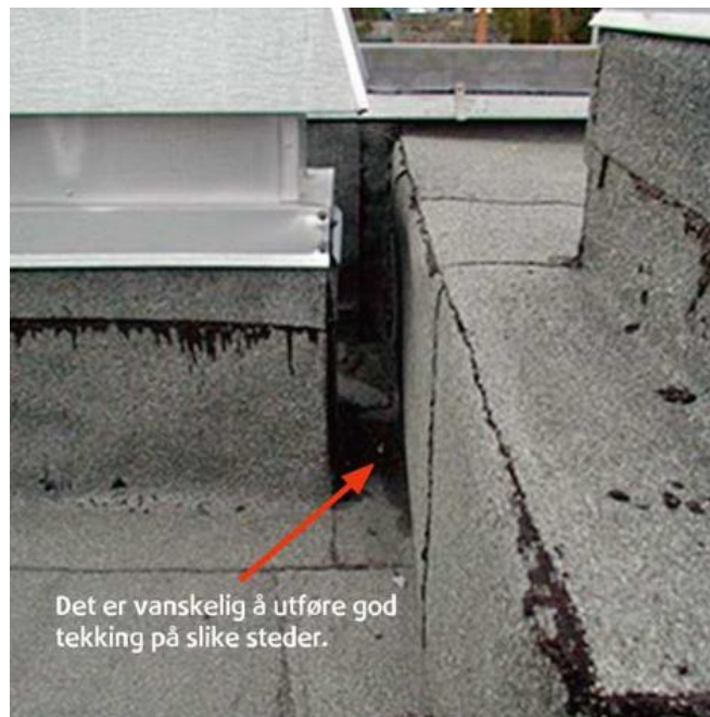
Figur 41: Eksempel på gjennomføringer plassert på en måte slik at tekkearbeidet blir utfordrende å utføre på riktig måte. Hentet fra: Byggforskserien 725.118 Skader i kompakte tak. Årsak og utbedring. [8]
