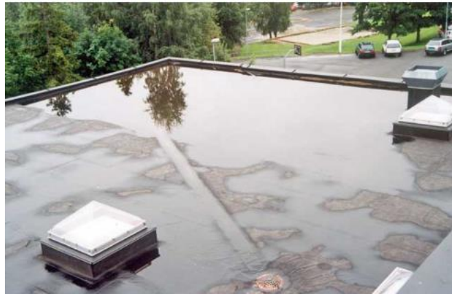
Figur 38: For lite fall mot sluk og manglende overløp fører til vanddammer på tak. Hentet fra: SINTEF. [77]
