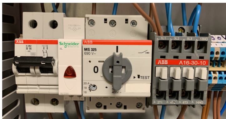
Figur 37: Sikkerhetskomponentene montert på 230V-skinnen i styreskapet. F.V: Sikring, varsellampe, motorvern, kontaktor
