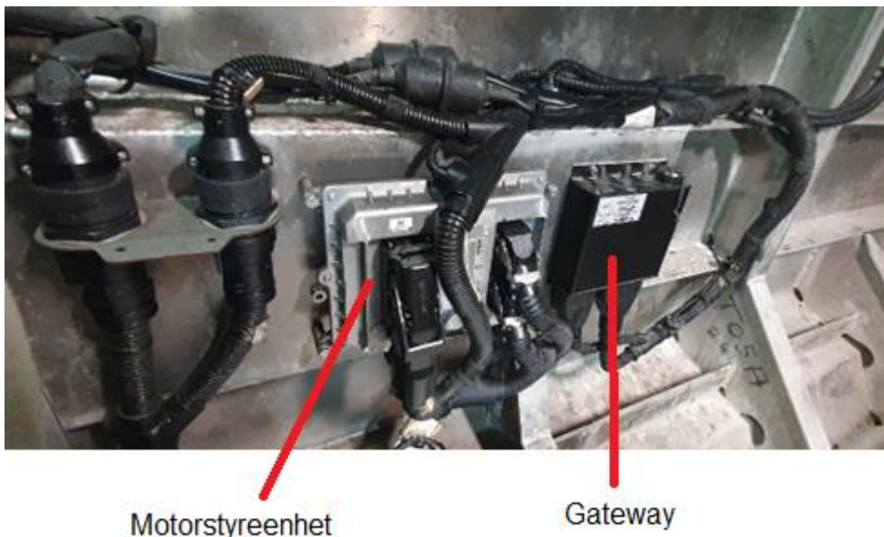
Figur 38 Gateway og dens tilkobling til Gullholms motorstyreenhet med CAN bus, bilde fra andre befaring.
