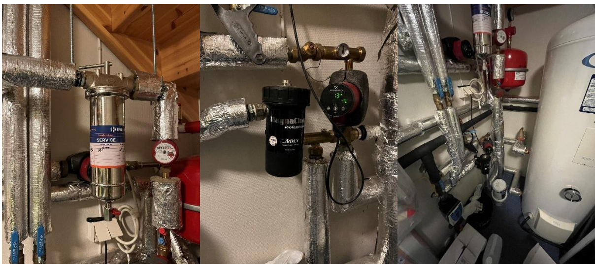
Figur 37 - Vannbehandlingsanlegg montert i Rønvik menighetsbarnehage
