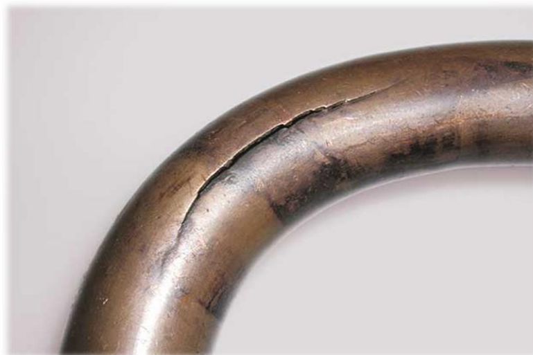
Figur 9 - Spenningskorrosjon på kobberør [7]
