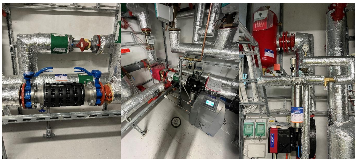
Figur 31 - Vannbehandlingsanlegg montert i Meierikvartalet
