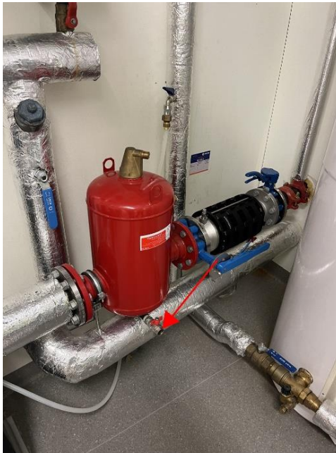
Figur 40 - Vannprøvepunkt Seilasveien borettslag
