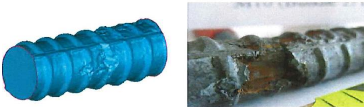
Figur 24 Eksempel på pittingkorrodert armeringsjern [30]
