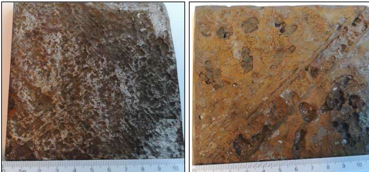
Figur 11. Bilder av overflater på to områder som ble undersøkt for korrosjonsangrep. a) Midtpunkt og b) bunn (Mjøsbrua, 2018).
