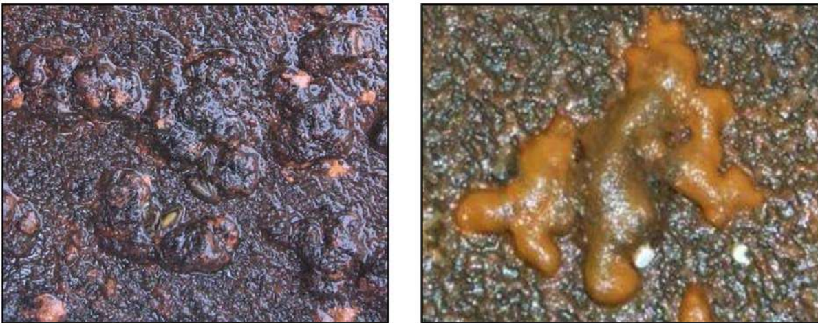
Figur 14. Tuberkler i områder med alvorlig korrosjon – før (venstre) og etter (høyere) rensing (men tuberkelen er ikke fjernet) (Clark et al., 2010; Lee et al., 2011).
