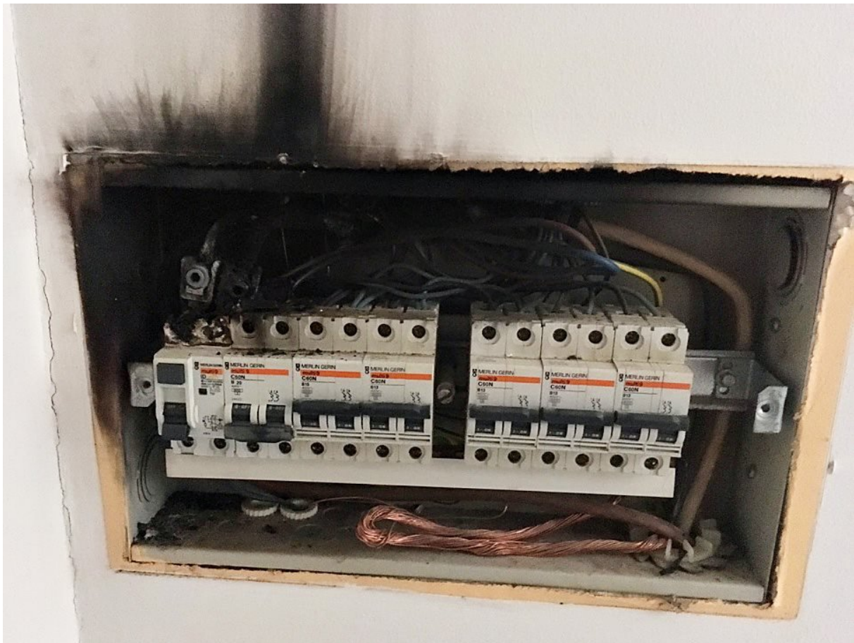
Figur 6: Hendelse i Tønsberg med eksplosjonslignende lyd i sikringsskapet [5]
