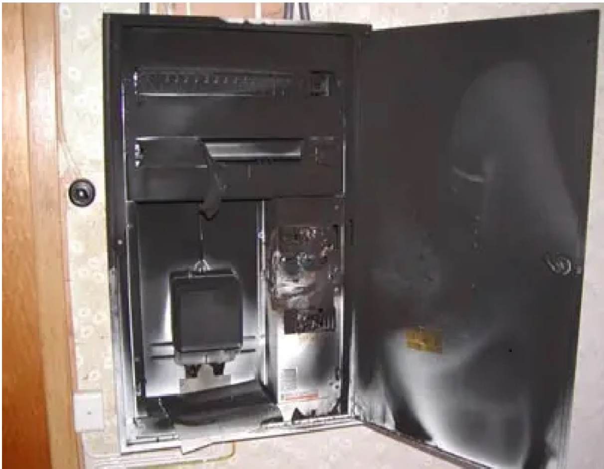
Figur 7: Sikringsskap etter et kraftig tordenvær i Forsand[6]
