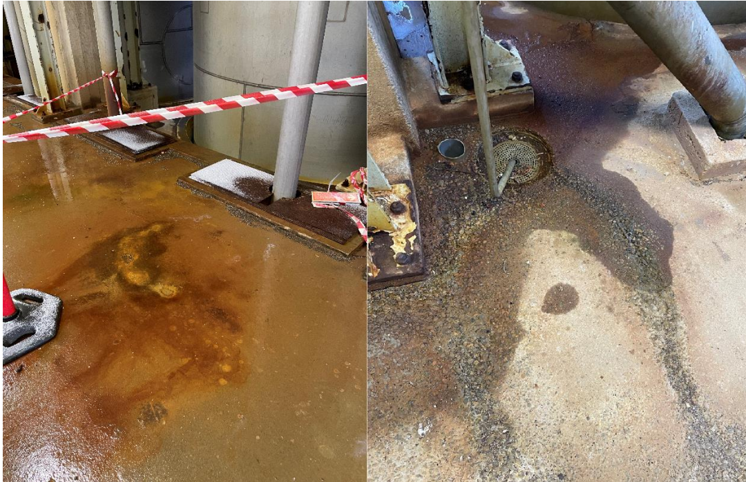
Figur 4.3 Synlig tilslag, misfarging og avsperring på oversiden av dekket
