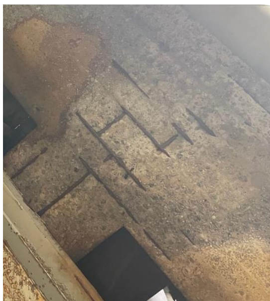
Figur 4.4 Forvitring og synlig armering på undersiden
