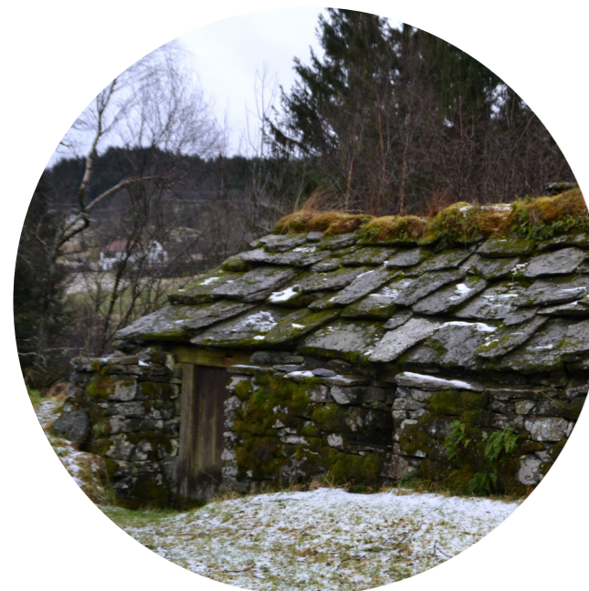
Det finnes flere eldre bygg som er mer eller mindre utelukkende laget i stein. Fra Osterøy museum
