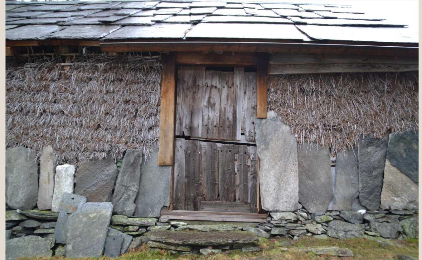
Fasade med stein nederst, som står i mot slagregn, og brake på toppen som slipper vinden gjennom.
