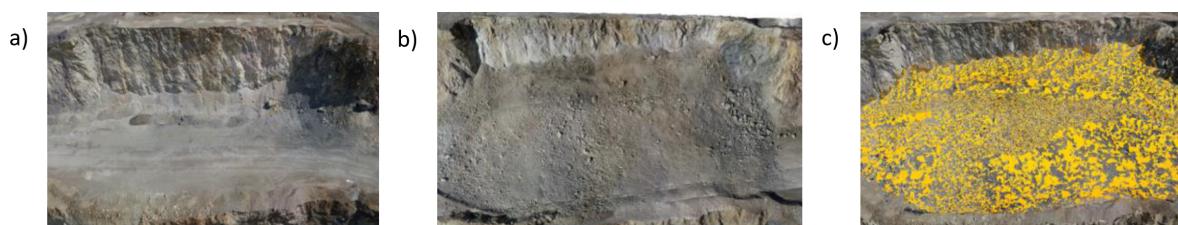
Figur 6.7: Volume Calculator benyttet på utsprengt bergskjæring. a) viser bergskjæringen før sprengning, b) viser bergskjæringen etter sprengning med utsprengte masser i front, c) viser massevolumet etter sprengning markert med gult, automatisk beregnet av programmet. Figur hentet fra 3GSM (2023f), modifisert.
