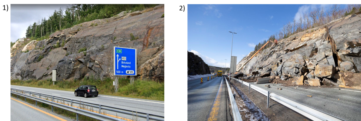
Figur 8.1: Bergskjæringen i Lillesand før og etter raset i mars 2023. Bilde 1) er hentet fra «street view» i Google Maps, og skjæringen er avbildet i mai 2022. Bilde 2) er hentet fra bygg.no og tatt av Tor Erik Schrøder / NTB like etter raset i mars 2023.
