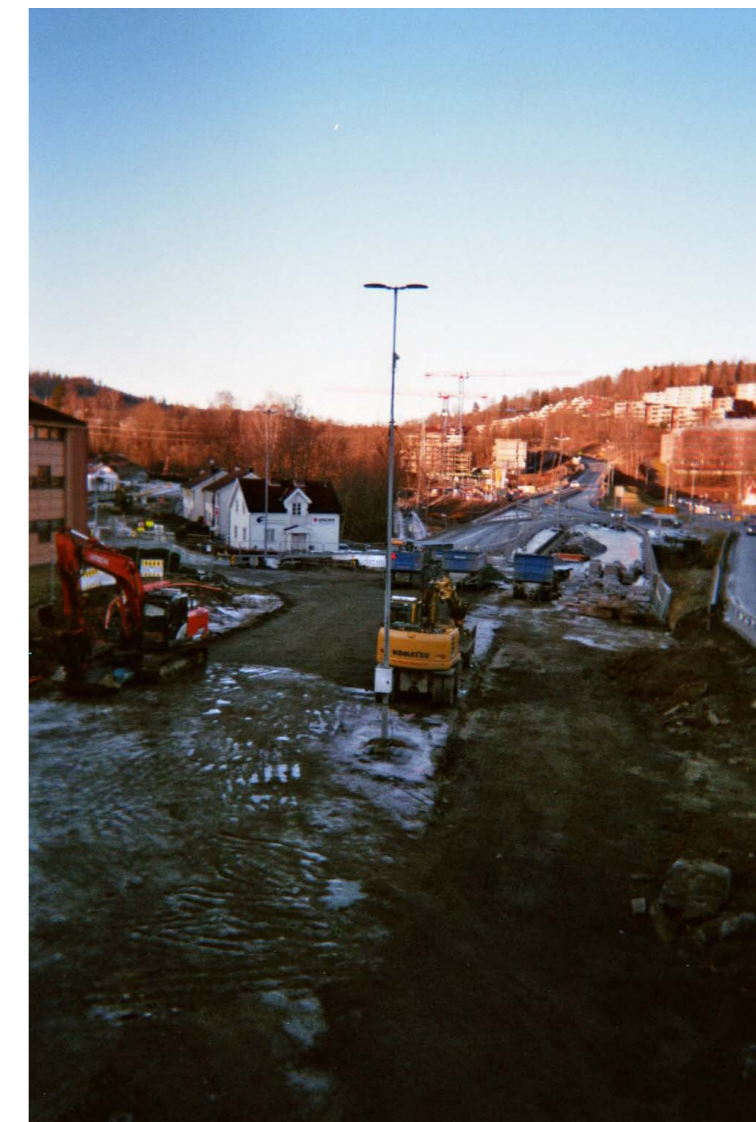
Fotografiet er tatt med engangskamera i januar 2020. Gamle E16 er nå lagt i tunnel og det foregår anleggsarbeid på stedet.
