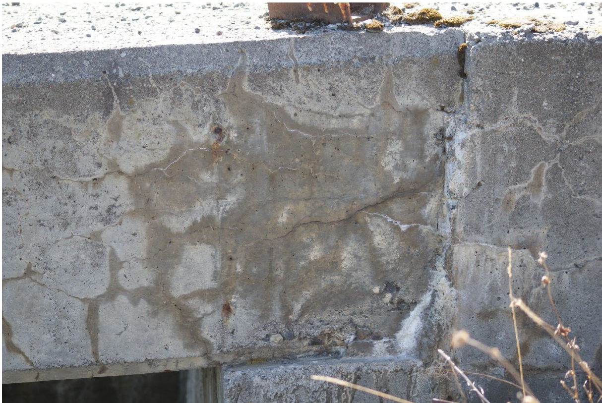
Figur 2-6: Figuren viser lokal knusing i fugen grunnet ekspansjon. (Marinekaia Alta, Multiconsult 2019)
