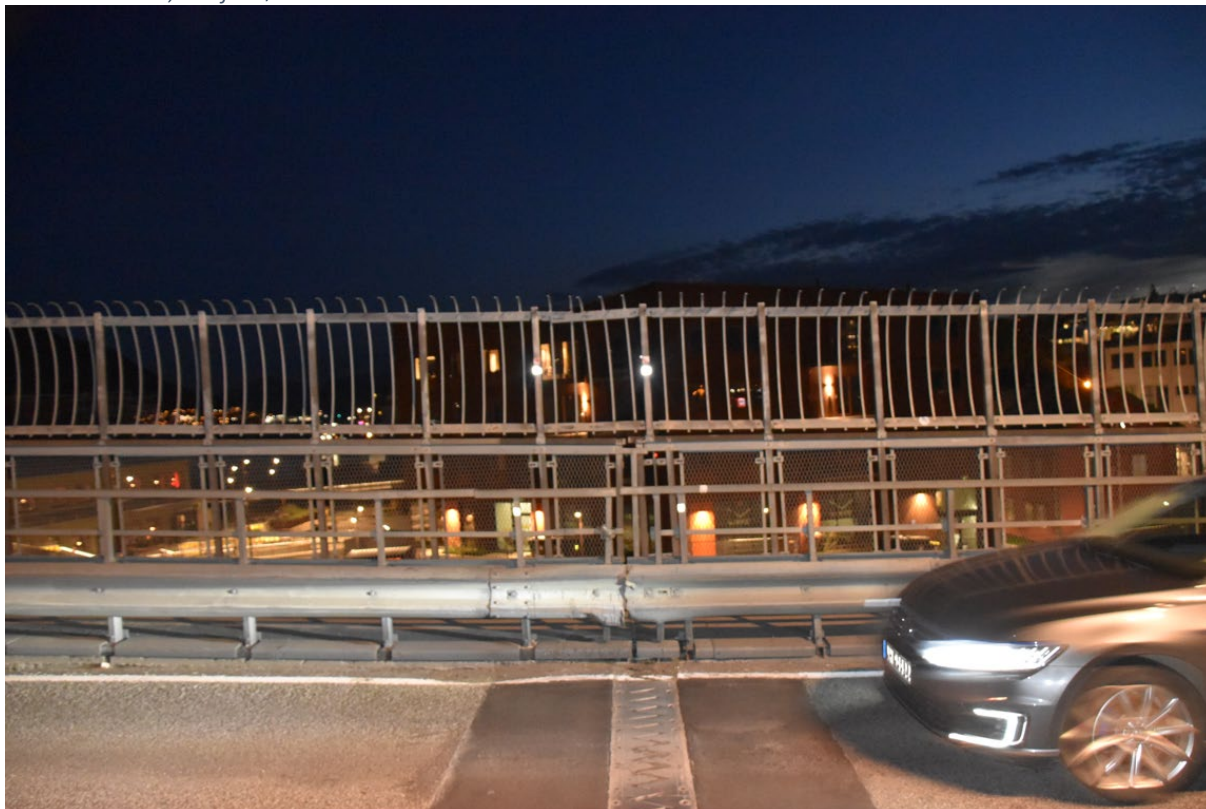
Bilde 27: Rekkverk deformert ved fuge. Bilde tatt av Multiconsult 28.09.2021
