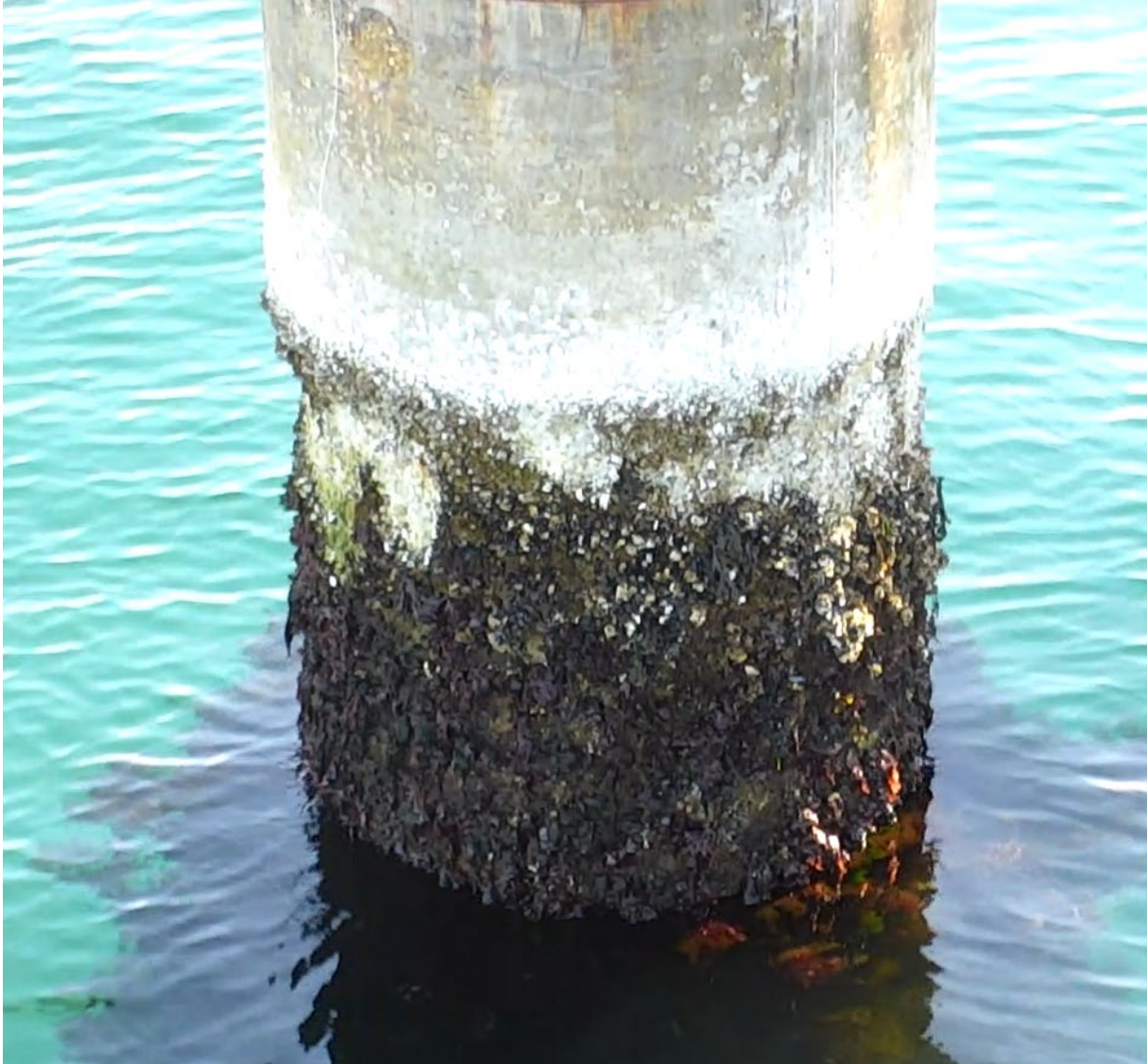
Bilde 15: Akse 19N: Frost/forvitring i tidevannssonen.
