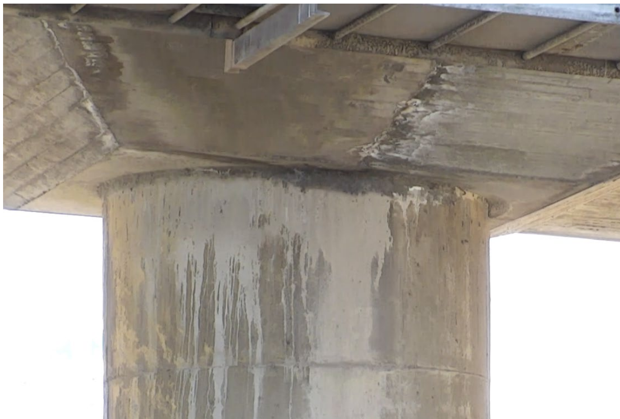
Bilde 2: Akse 6 Fukt/kalkutslag i støpeskjøt overbygning
