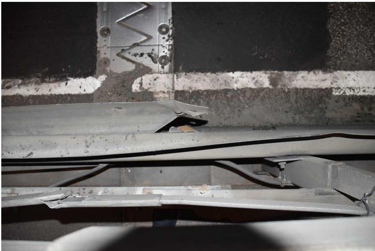
Bilde 28: Rekkverk deformert ved fuge. Bilde tatt av Multiconsult 13.12.2021
