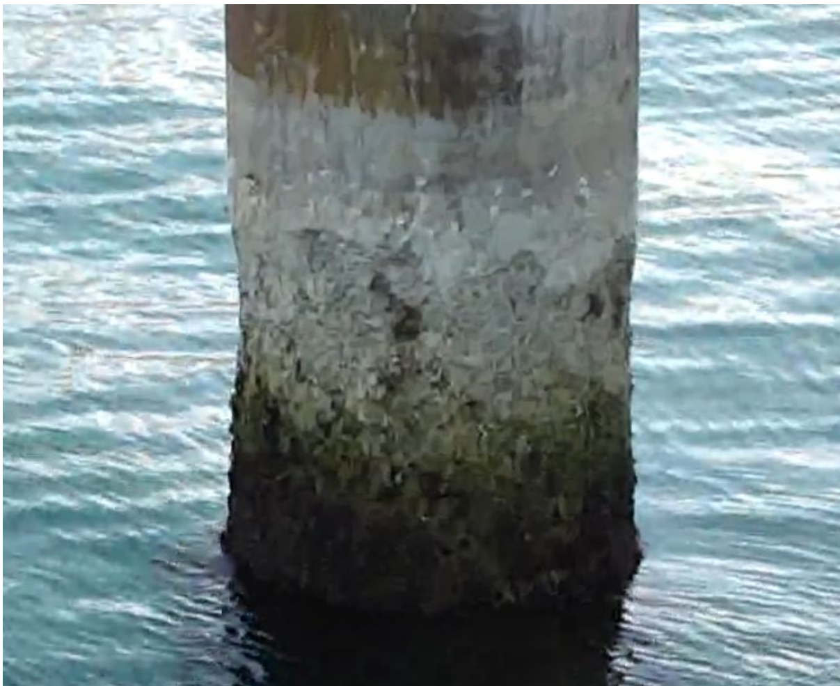
Bilde 16: Akse 20 nord. Redusert tverrsnitt grunnet frost/forvitring.
