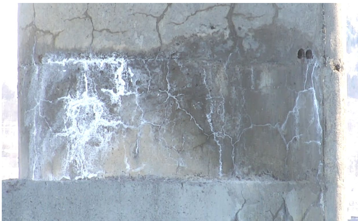
Bilde 10: Seksjon B, fra nord, fukten transporteres ut igjennom støpeskjøt
