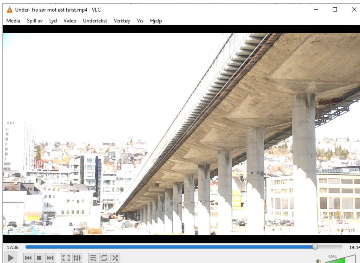
Bilde 5: Seksjon A, fra sør, pilarer fuktige i toppen
