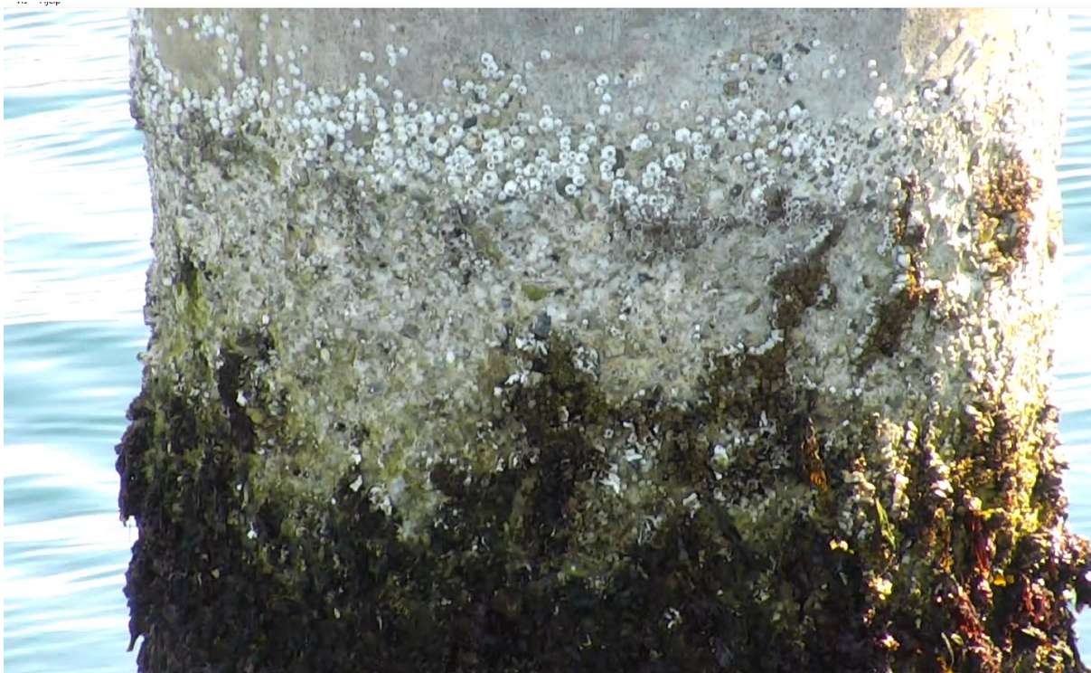
Bilde 17: Akse 20, Pilar sør sett fra nord. Redusert tverrsnitt grunnet frost/forvitring.
