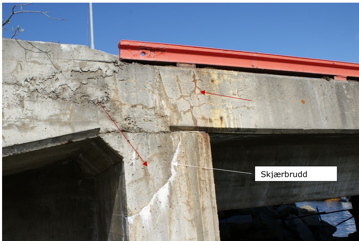
Figur 2-4: Figuren viser lukking av fuge mellom landkar og kaiplate. Grunnet ekspansjon er det oppstått et skjærbrudd i landkarvegg. Røde piler peker på typiske krakeleringssriss (Marinekaia Alta, Multiconsult, 2019)
