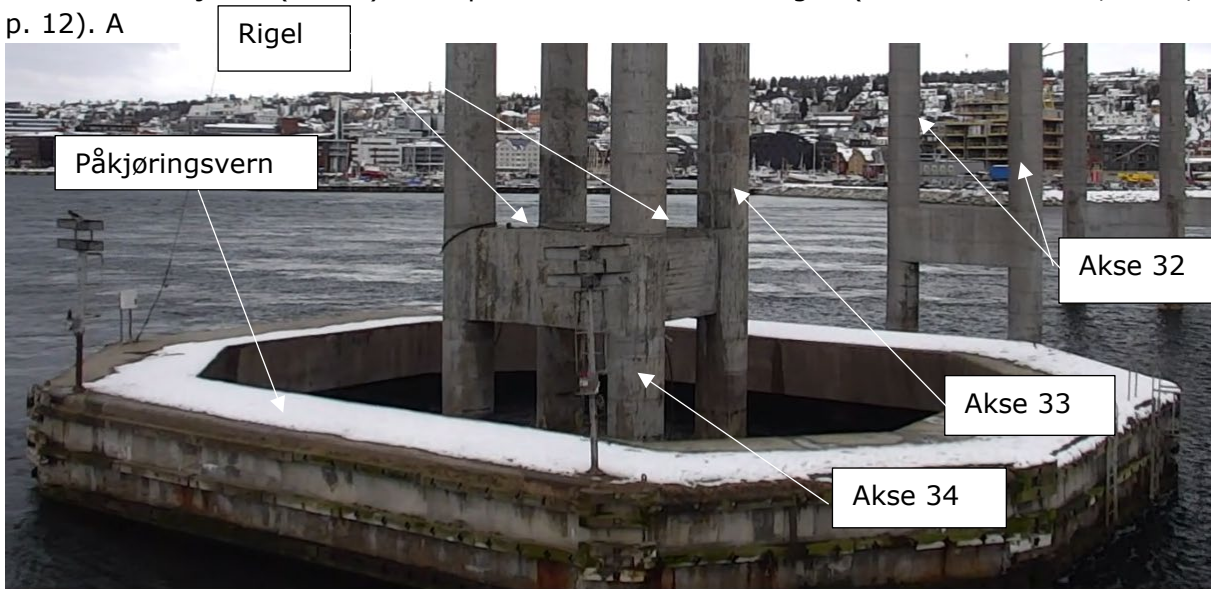
Figur 3-12: Bildet viser nedre del av pilarene i akse 32-34. Bildet er tatt fra mot Tromsøya. Bildet er hentet fra dronefilm. (NORCE, 2021)
