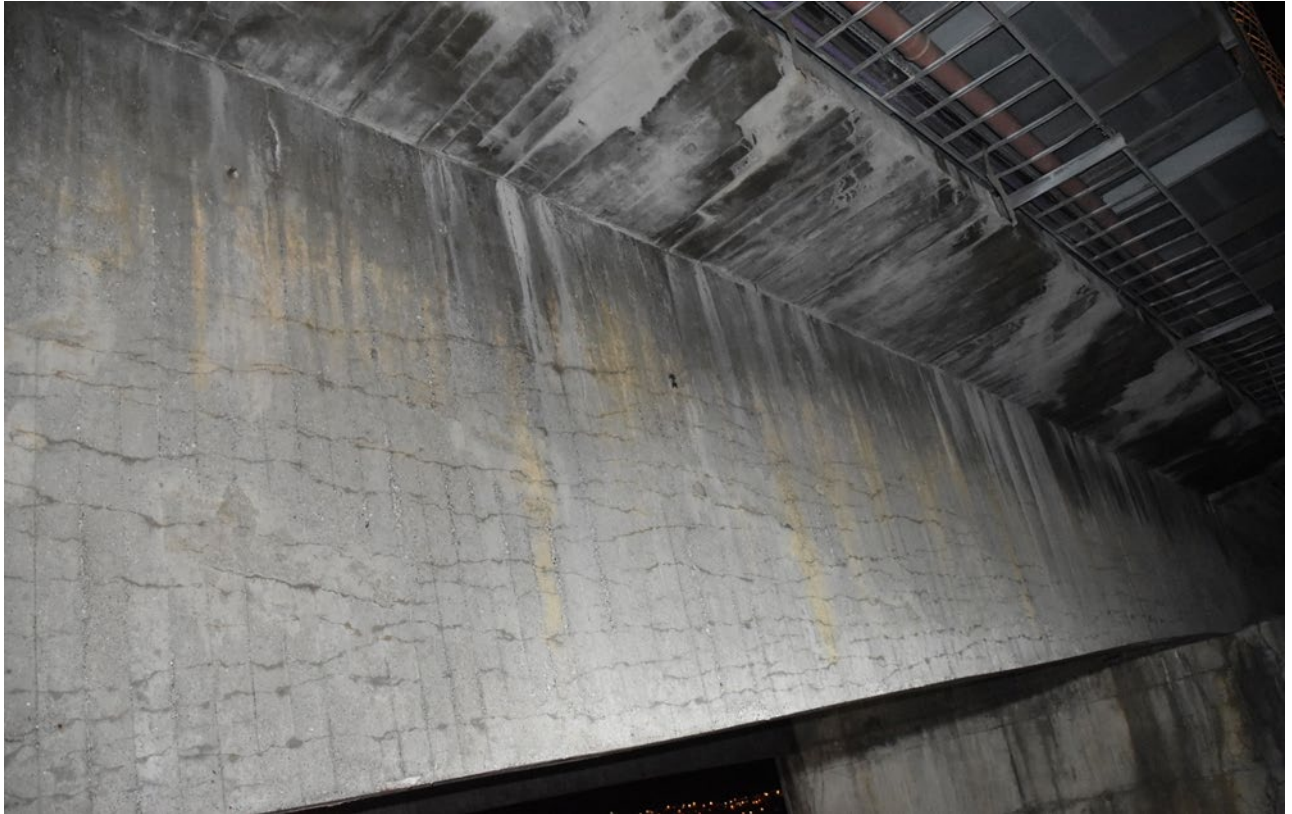
Figur 2-2: Bilde viser langsgående riss i en spennarmert kasse. Rissene følger retningen på spennarmeringen. (Tromsøbrua felt 36, Multiconsult, 2021)
