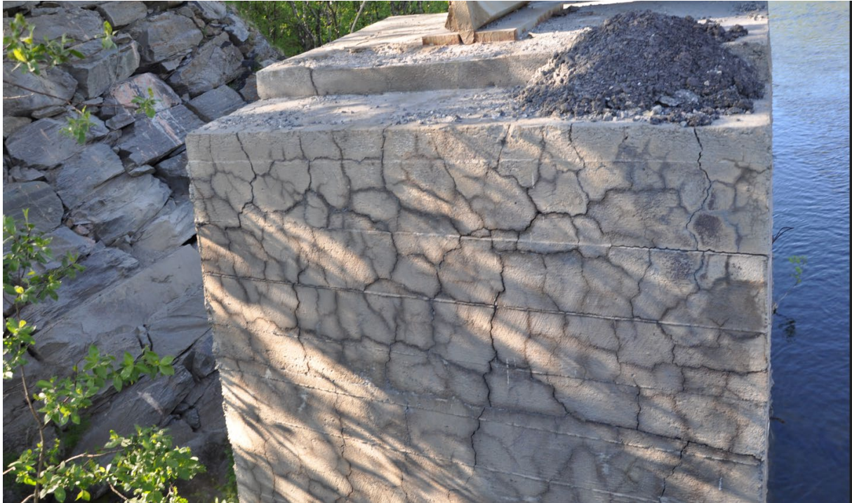
Figur 2-5: Figuren viser typiske krakeleringssriss fra AR. (Mathiselv bru Finnmark, Multiconsult 2012)
