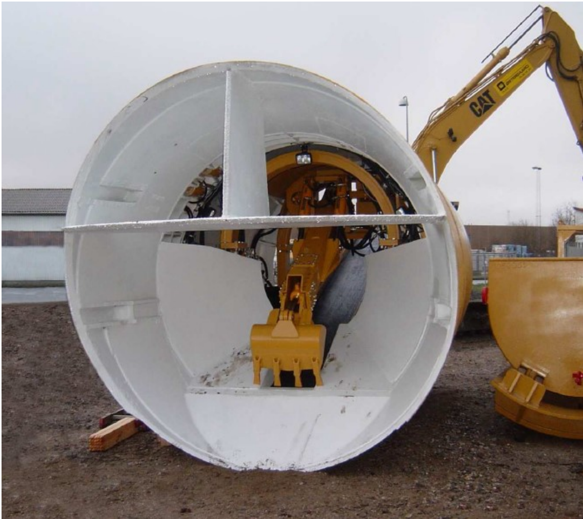
Figur 6: Startrør med åpen rørfront kilde[14]
