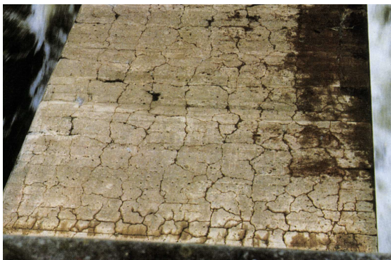
Figur 2.5.3: Distinkt rissmønster i betongkonstruksjoner utsatt for alkalireaksjoner, også kalt krakeleringsmønster [34].
