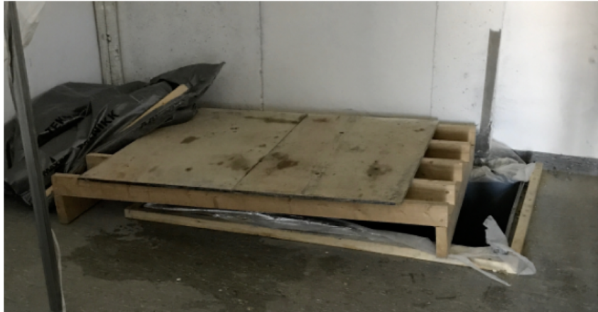
Figur 11: Sikringslem over ventilasjonskanalen i teknisk rom.
