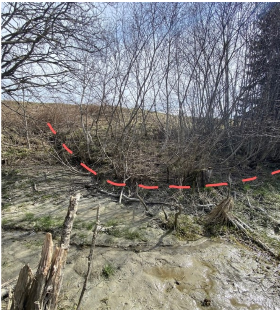
Figur 5.12: Feltobservasjoner fra lokalitet C: Sekundær utglidning som har oppstått i nedsynkningen som er lokalitet C.
