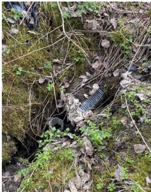
Figur 5.19: Dreneringsrør ved lokalitet D, lagt i forbindelse med jordbrukvirksomhet.
