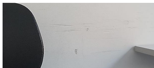
Figur 38 Sår og merker på vegg, (foto: Skuseth, 2023)
