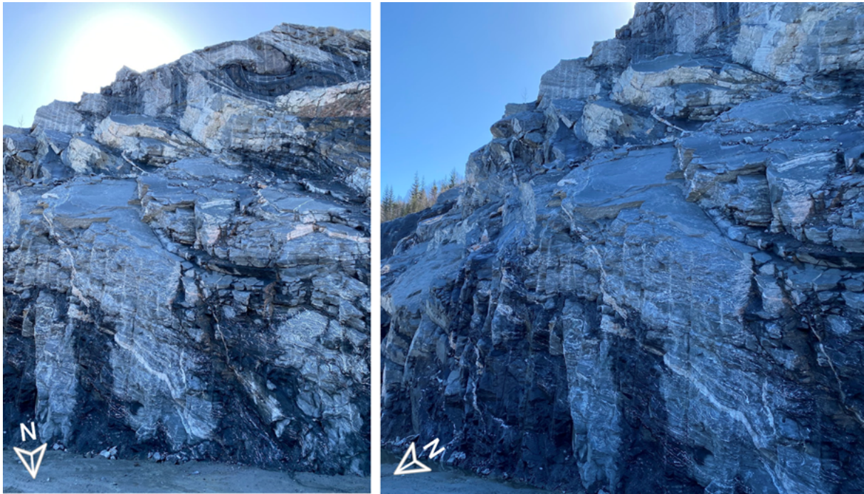
Figur 9.3: Bilder av skjæring tatt etter sprenging, 19.04.2023. Tydelig utglidning langs foliasjon under sprenging.
