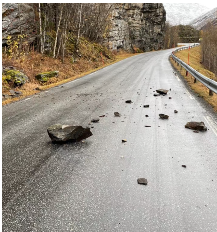
(b) Steinsprang på veg i Geiranger (Sunnmørsposten 2019).
