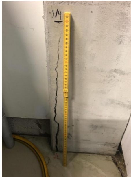
Figur 47: Skade på bæresøyle.
