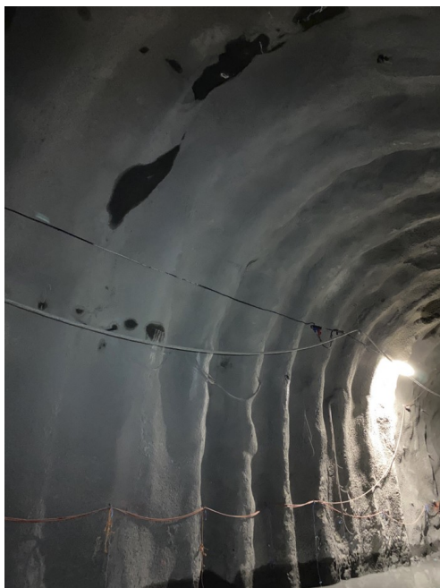
(a) Fuktkartlegging pelenummer 9120 retning nord
