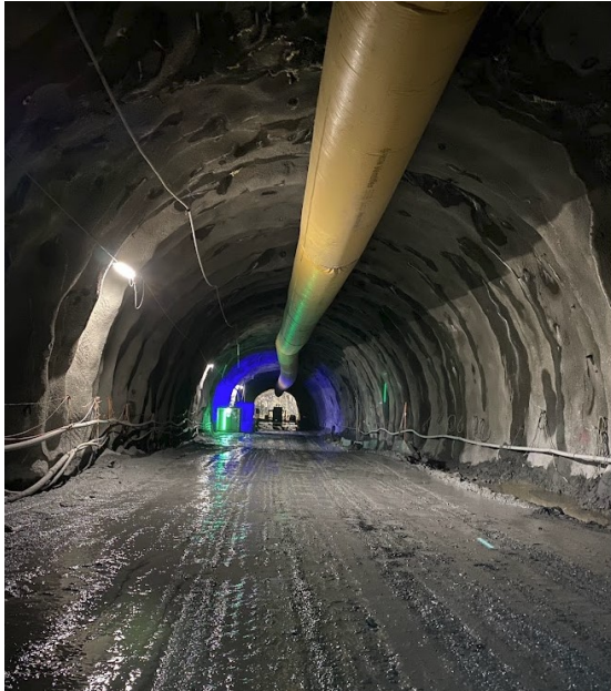
(a) Fuktkartlegging pelenummer 8025 - Nordgående retning. Dato: 18.01.2023
