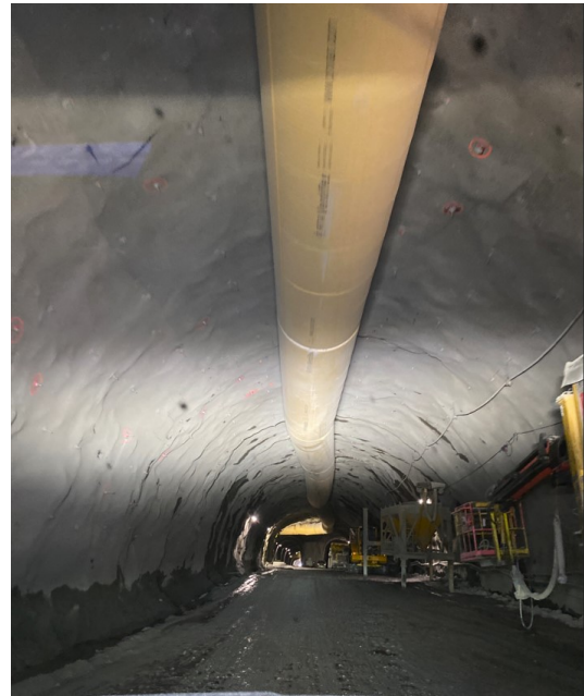
(b) Fuktkartlegging pelenummer 8117 - Sørgående retning. Dato: 31.03.2023
