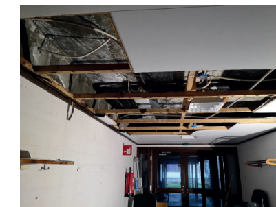
TYPISK SKADE PÅ TAKPLATER
