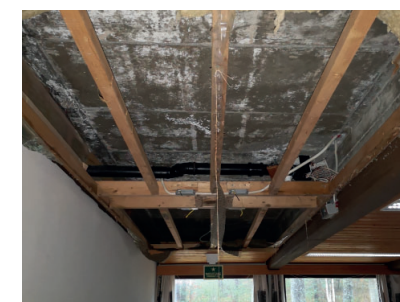
MUGGSKADE PÅ BETONG
