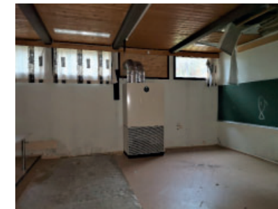
VARMEPUMPE I AUDITORIUMET
