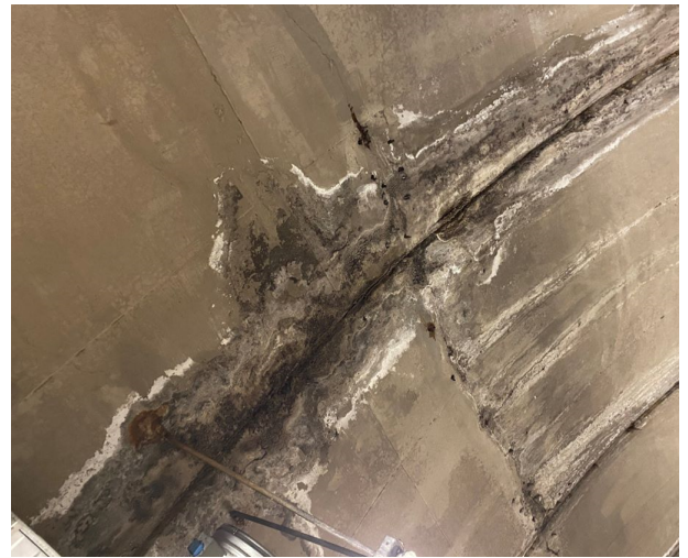
Figur 5.7: Oppsprukket betong på stasjonsområdet. (Foto: Geir Dehli (Sporveien)).
