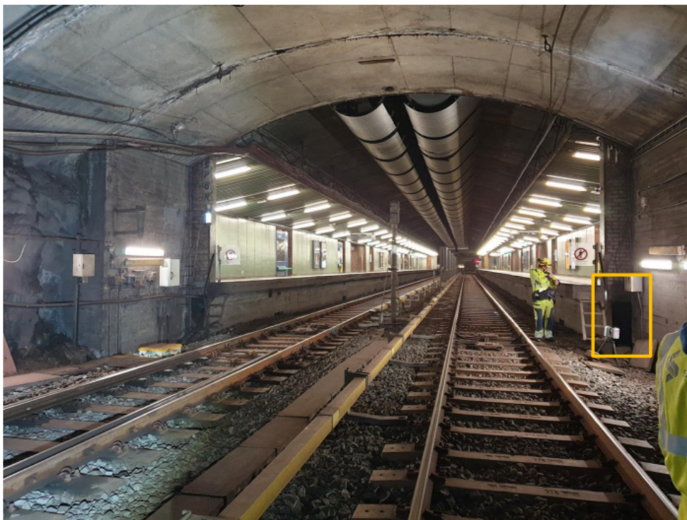
Figur B.8: Spor 1 og 2. Gult omriss viser adkomst til Heibergløkka tverrslag under plattform 2 (Foto: Eivind Sømme Berget).
