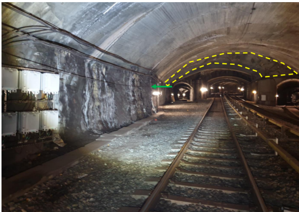
Figur B.11: Bilde sett i retning nordøst ut fra stasjonshallen ved spor 1 og 2. Pilen viser hvor sjakta er planlagt å komme ned. Gult felt viser ny bergsikring (Foto: Eivind Sømme Berget i (Sweco, 2022)).
