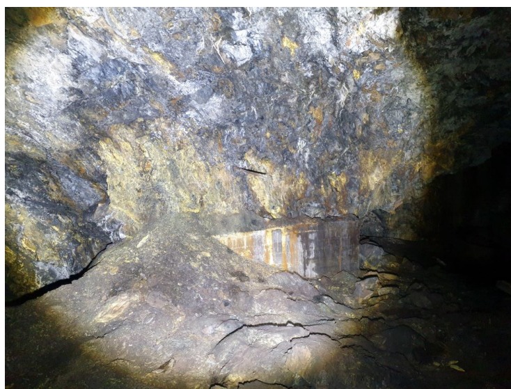
Figur 5.5: Bergmasse med gult forvittringsbelegg og nedfall av avløst materiale på bakken (Foto: Eivind Sømme Berget).
