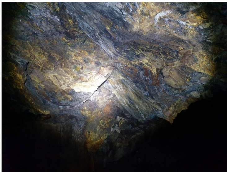
Figur 5.4: Gul utfelling på bergmassen ved Tøyen T- banestasjon i nærheten av plattform 2. (Foto: Eivind Sømme Berget).
