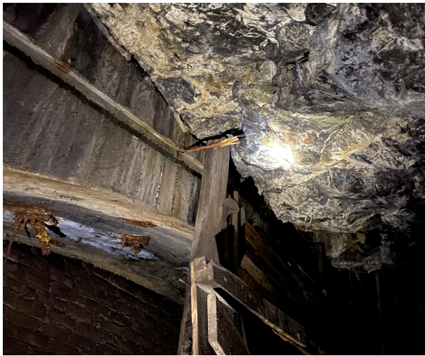
Figur 5.6: Korrosjon av stål ved plattform 1 og 2. (Foto: Geir Dehli (Sporveien)).
