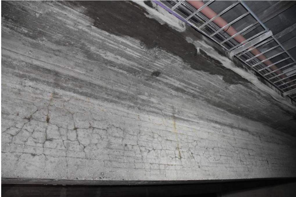
Figur 5-1 Krakelingsriss i bjelke mellom akse 26 og 27. Bildet er hentet fra vedlegg til Multiconsults spesialinspeksjon i 2022. (Fredheim, 2022)
