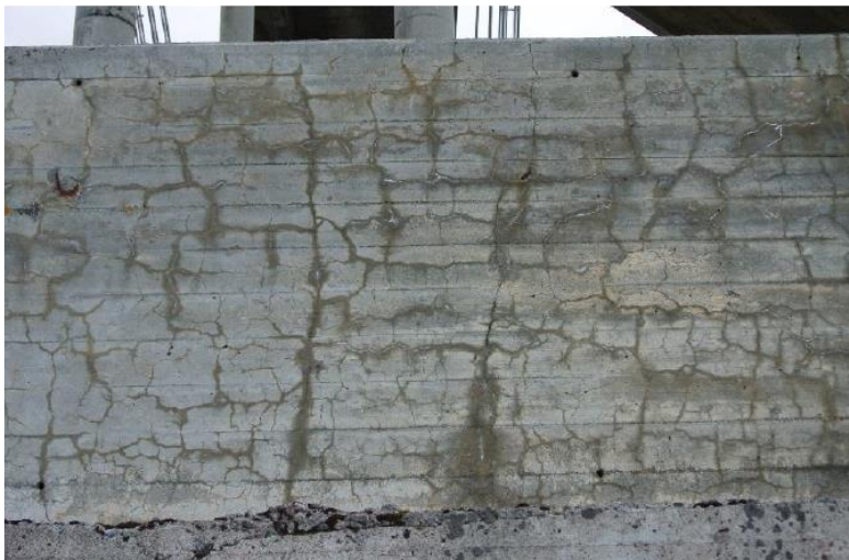
Figur 2.3: Typisk krakeleringsriss i konstruksjonsdel som er fri til å ekspandere i alle retninger med mørke skygger rundt rissene siden alkaligelen i rissene holder på fukt [9]
