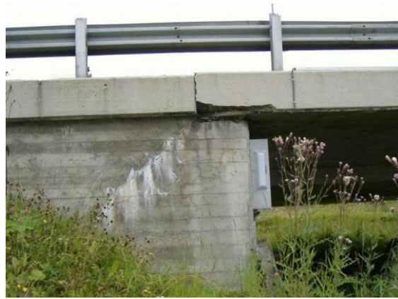
Figur 2.6: Utvidelse av bruplate, lukking av fuge og brudd i landkar [11]
