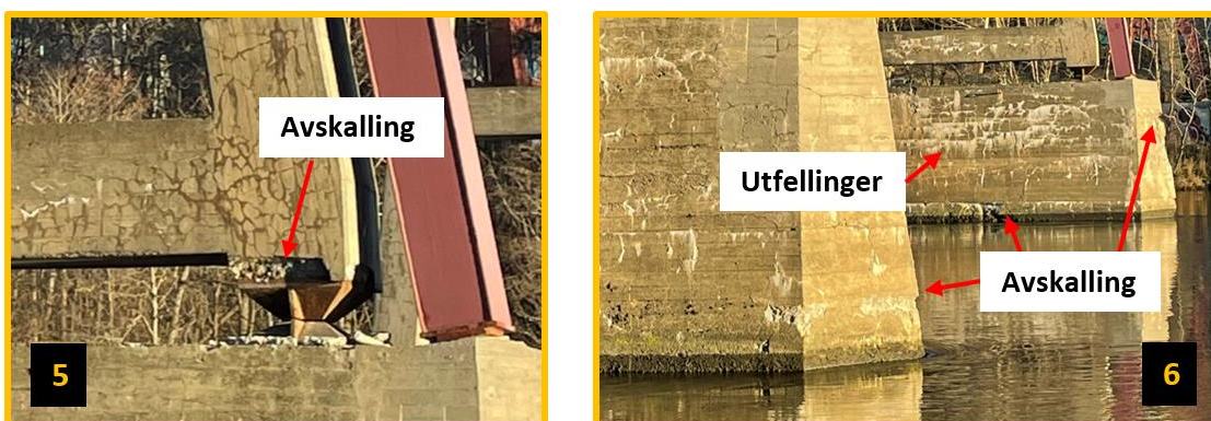
Figur 4.12: Detaljbilde som viser avskallinger rundt lager, samt utfellinger og avskallinger i fundamentet [Nina Valnes]
