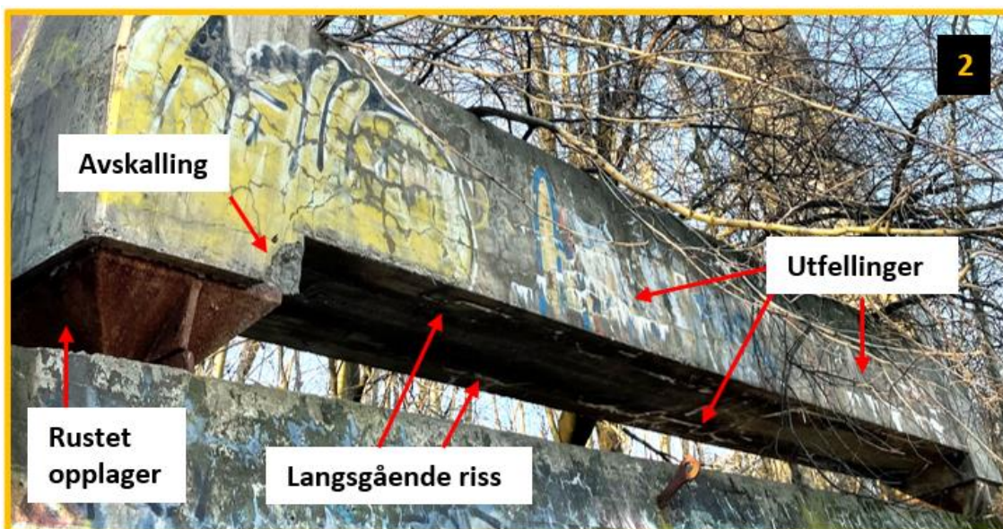
Figur 4.10: Detaljbilde som viser avskalling, rustet lager og langsgående riss med utfellinger i nedre tverrbærer [Nina Valnes]
