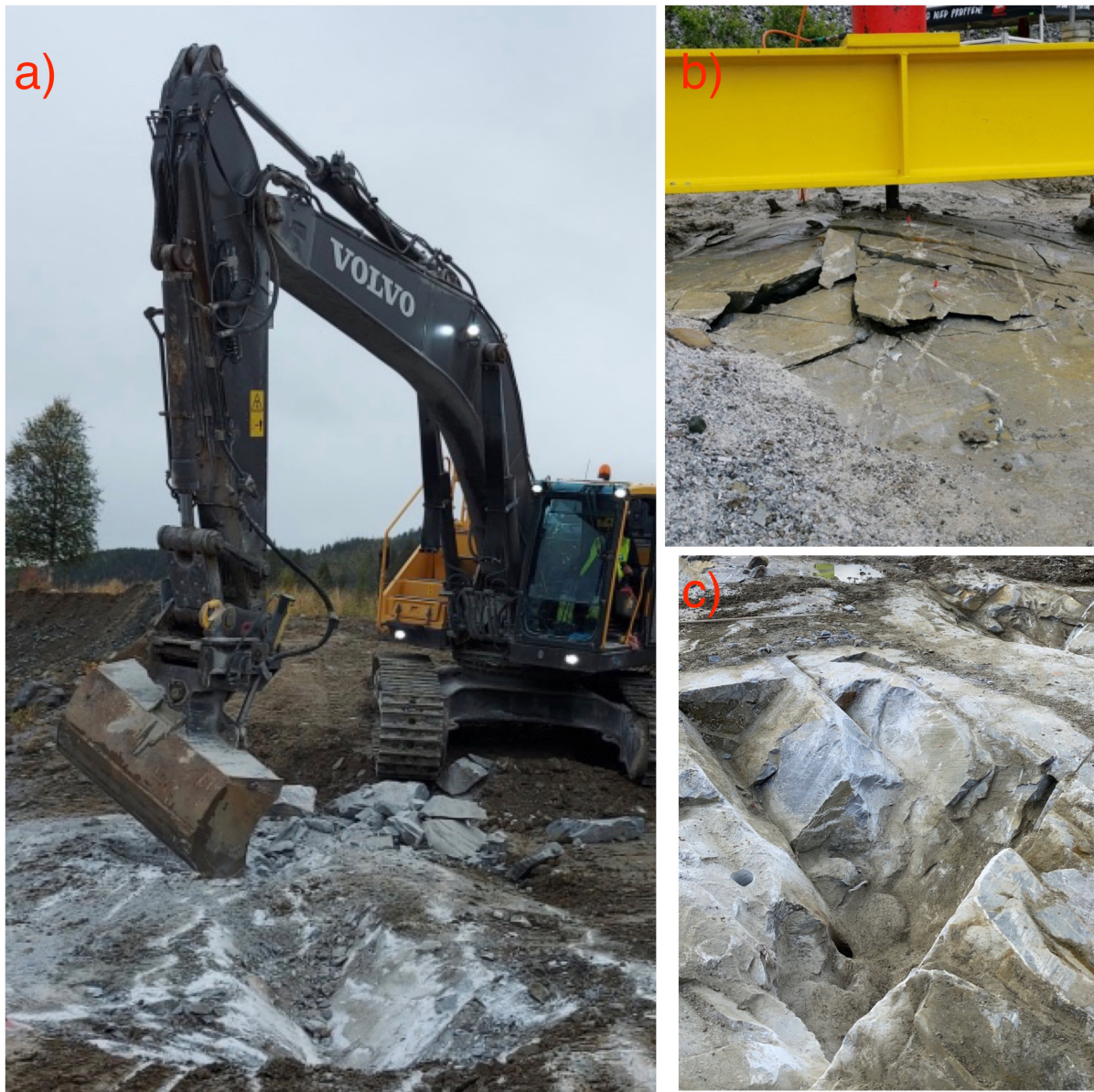
Figur 3.14: Bildene viser a) gravemaskinen som ble brukt for å grave ut de største blokkene fra bruddkrateret, b) bilde av A1m før rydding av bruddmaterialet, og c) bilde av B1.5m etter rydding av bruddmaterialet.
