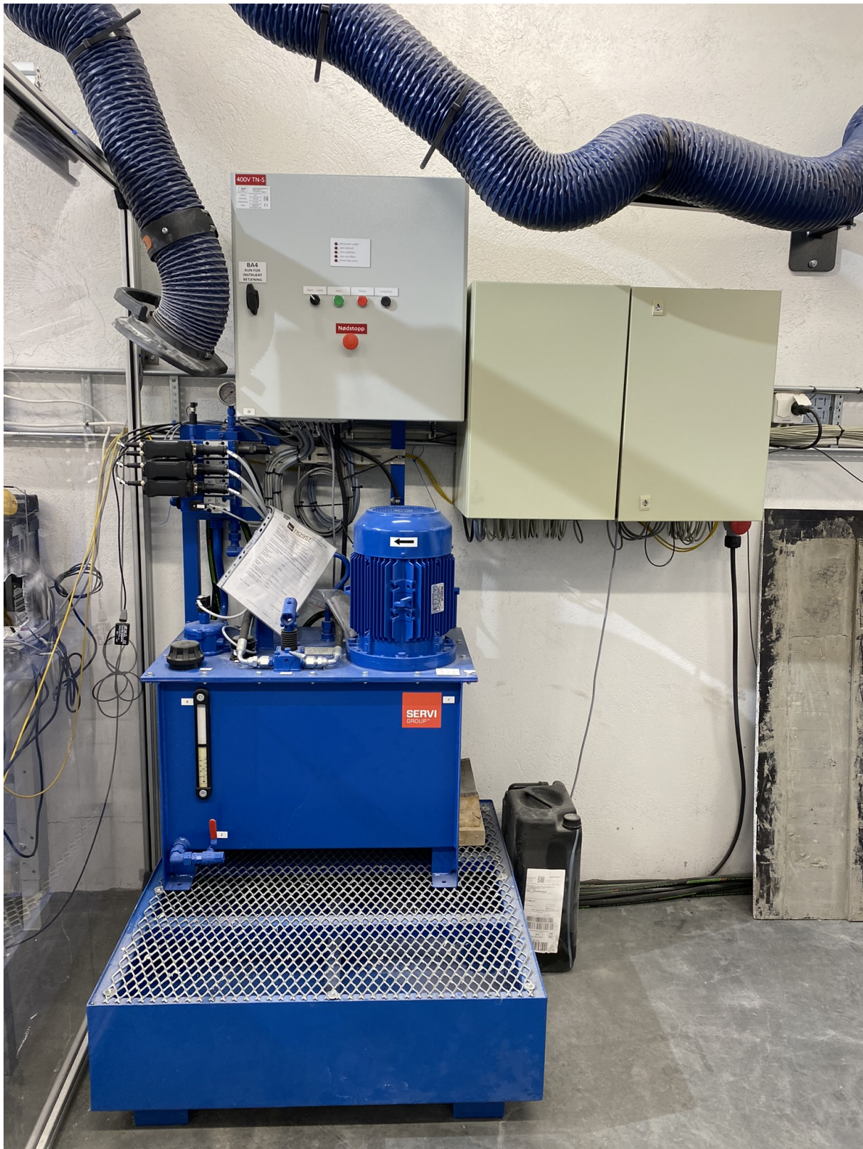
Figur 3.6: Det hydrauliske aggregatet og to koblingskap med alt det elektriske.
