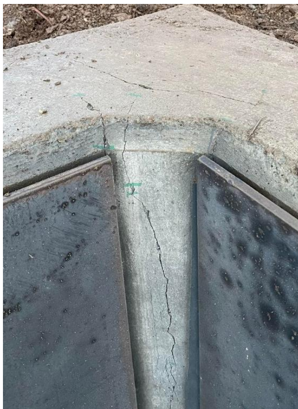
Figur 29: Rissdannelser i østre hjørne.
