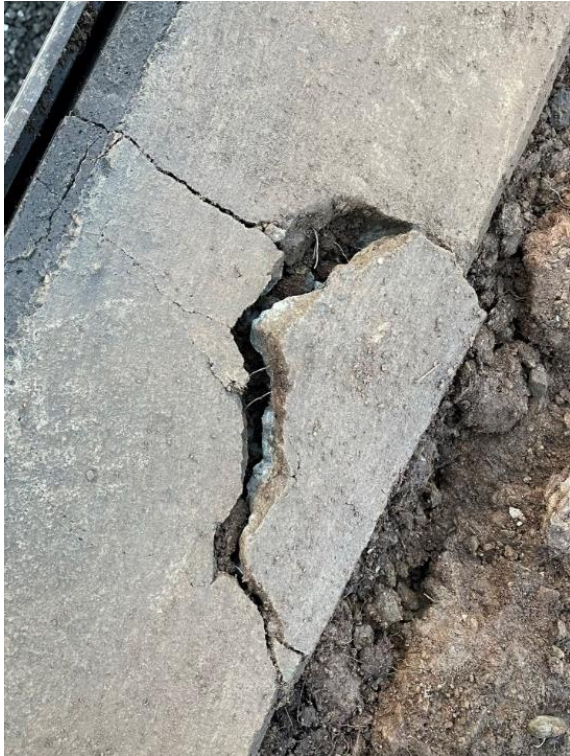
Figur 28: Avskalling og brudd i topp av bakveggen.
