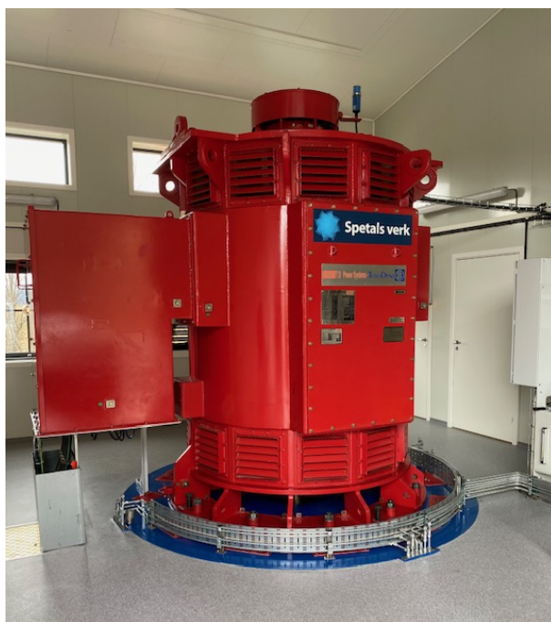
Figur 30: Generatoren i Mølnåa kraftverk.
