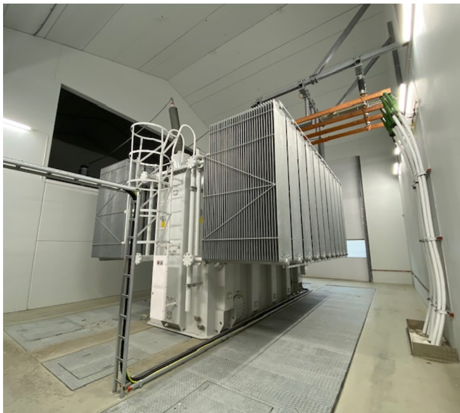
Figur 11: Krafttransformator på Stokkfjellet.
