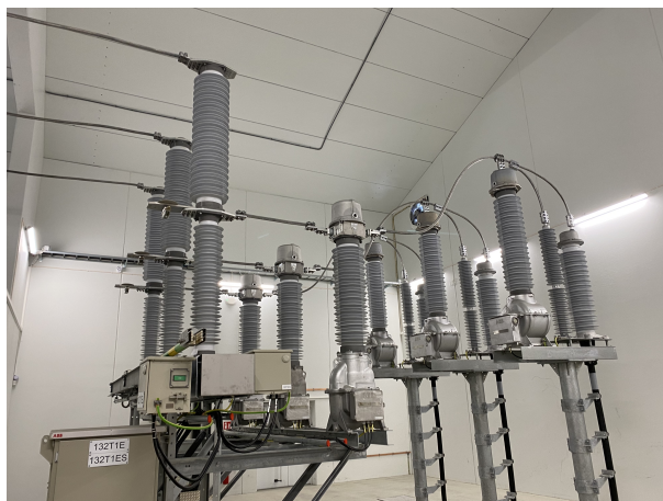
Figur 14: 132 kV delen av innendørs AIS-bryteranlegg på Stokkfjellet.
