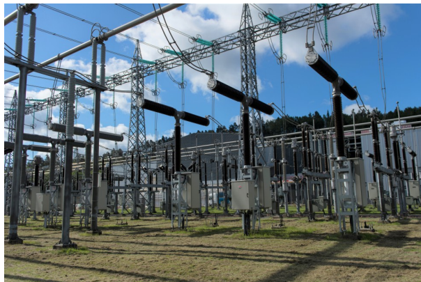
Figur 13: AIS - luftisoleret bryteranlegg, foto: Peter Tubaas/ABB.
