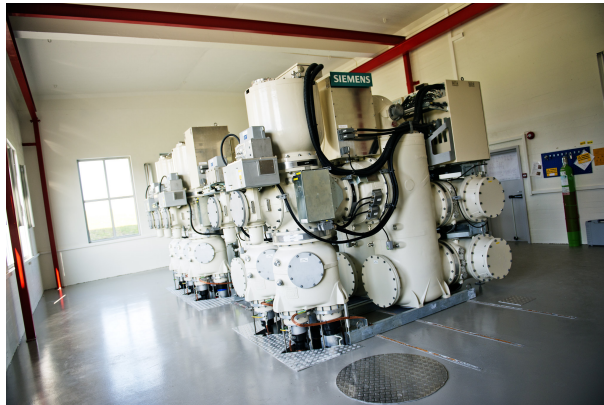
Figur 12: GIS - gassisoleret bryteranlegg, foto: Fredrik Ringe/Lyse Konsern.
