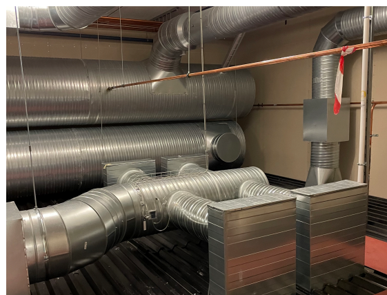
Figur 12: Ventilasjonsanlegg over operasjonssal
