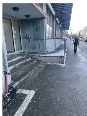
Figur 7.3: Rampe som stikker ut i fortau
