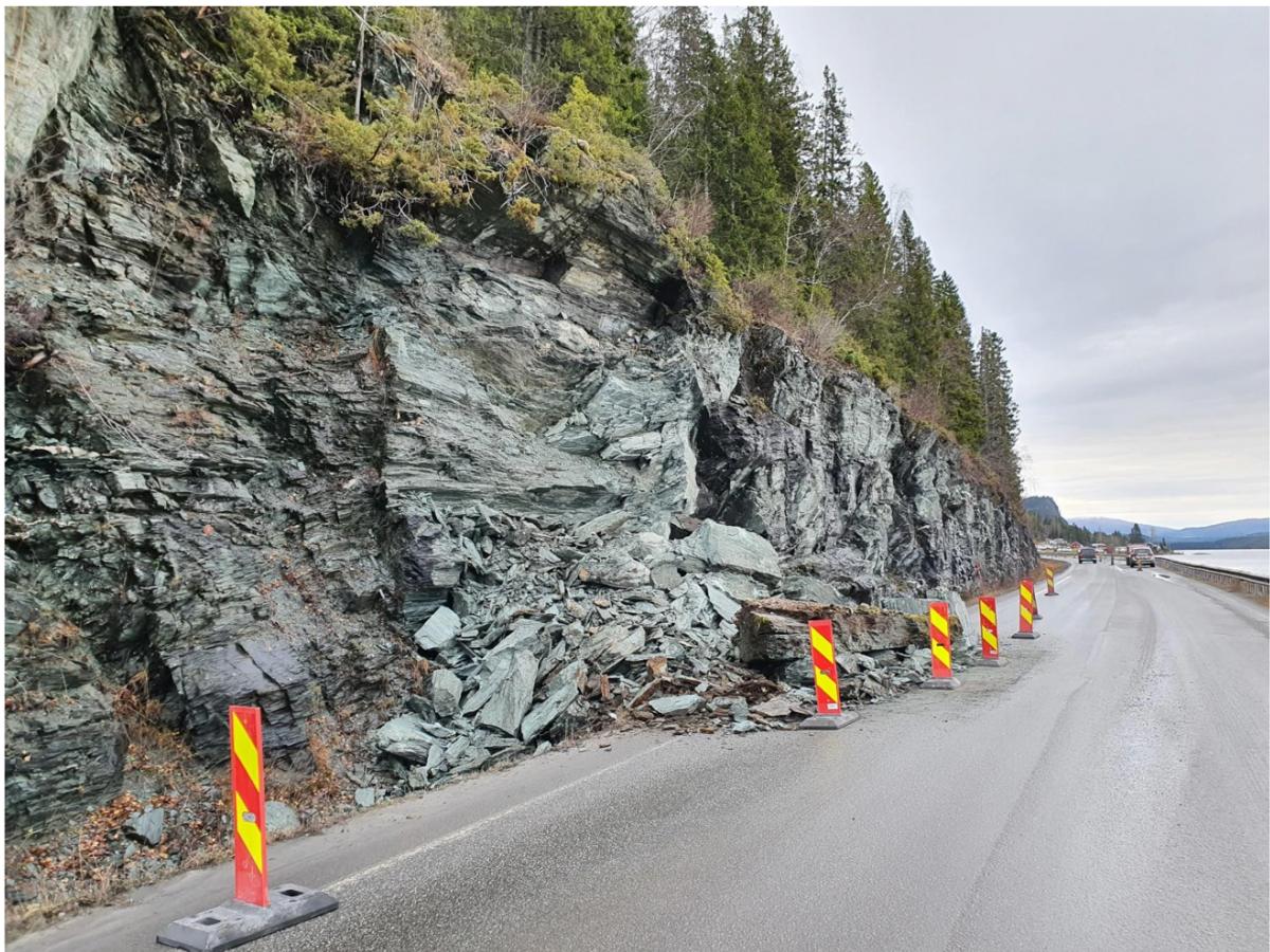
Figur 72: Skredhending mars 2020 viser korleis grøfta vert fylt opp og skredmassane går ut i E6. dersom det er større mengder med skredmassar. Foto er tatt mot aust av Jakobsen (2020).
