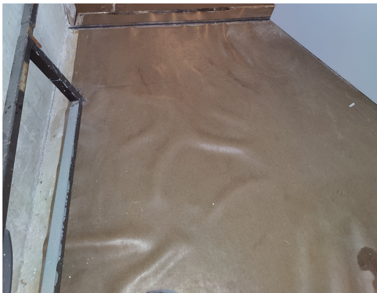
Figur 4.3.2: Vannskade gulv mot grunn
