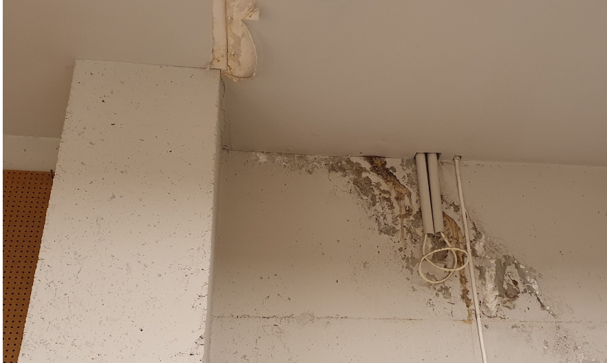
Figur 4.3.1: Vannskade vegg mot grunn
