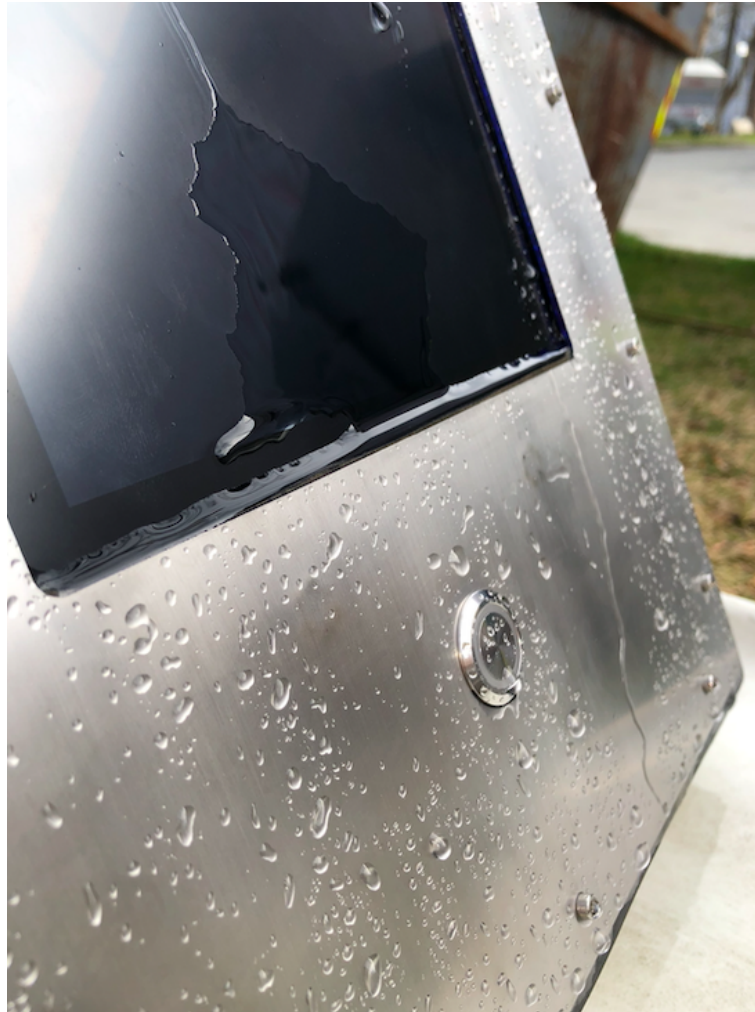
Figur 100: Området på terminalene som er utsatt for vannansamling og potensiell vanninfiltrasjon.
