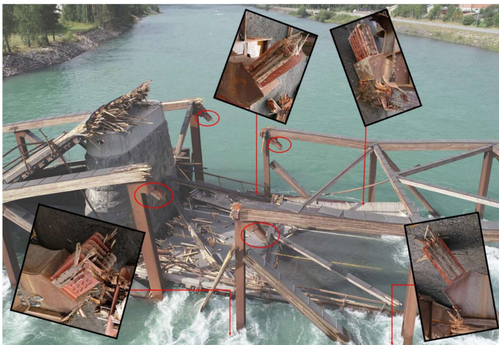
Figur 4-2 Vestre elvefundament (akse 2) etter kollaps
