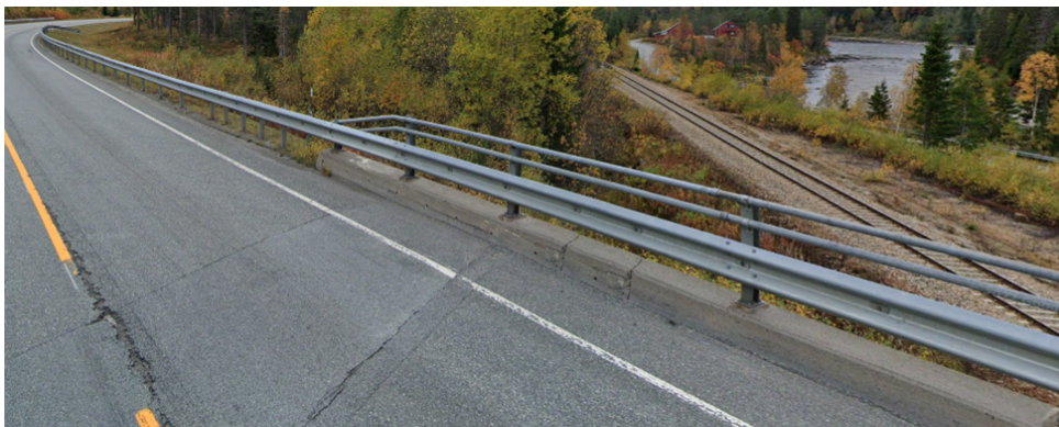
Figur 3.11: Oppsprukket veg ved bru 1 [9]
