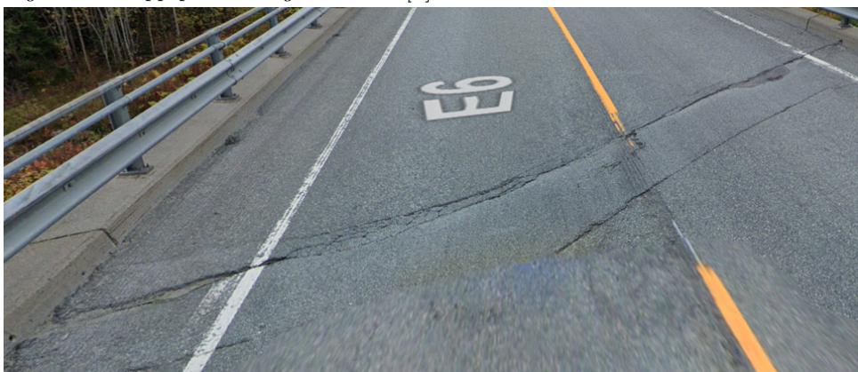
Figur 3.12: Oppsprukket veg ved bru 2 [9]
