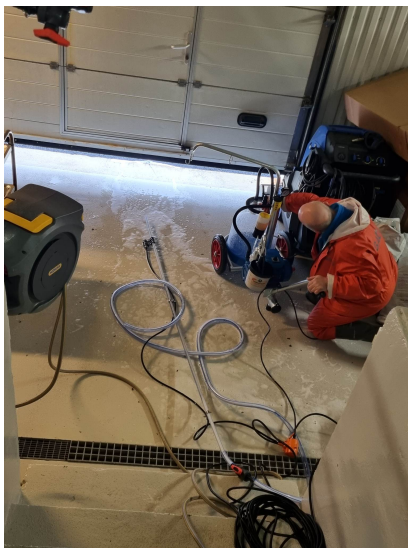
Figur 23: Vakuumpumpen blir såpelagt med Aqua Clean
