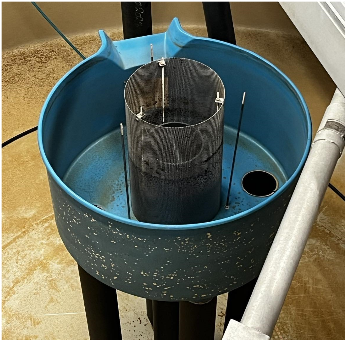
Figur 15: FTC (blå) i RAS 1 startförling i tømt kar (før nedvask). På bildet kan man se avløpsrøret i midten av FTC med rist rundt som hindrer at fisken kommer seg ut. Under FTC kan man se rørene som går ned til bunnen av karet, som suger opp slam og skitt. (Foto av Baglo 2023)
