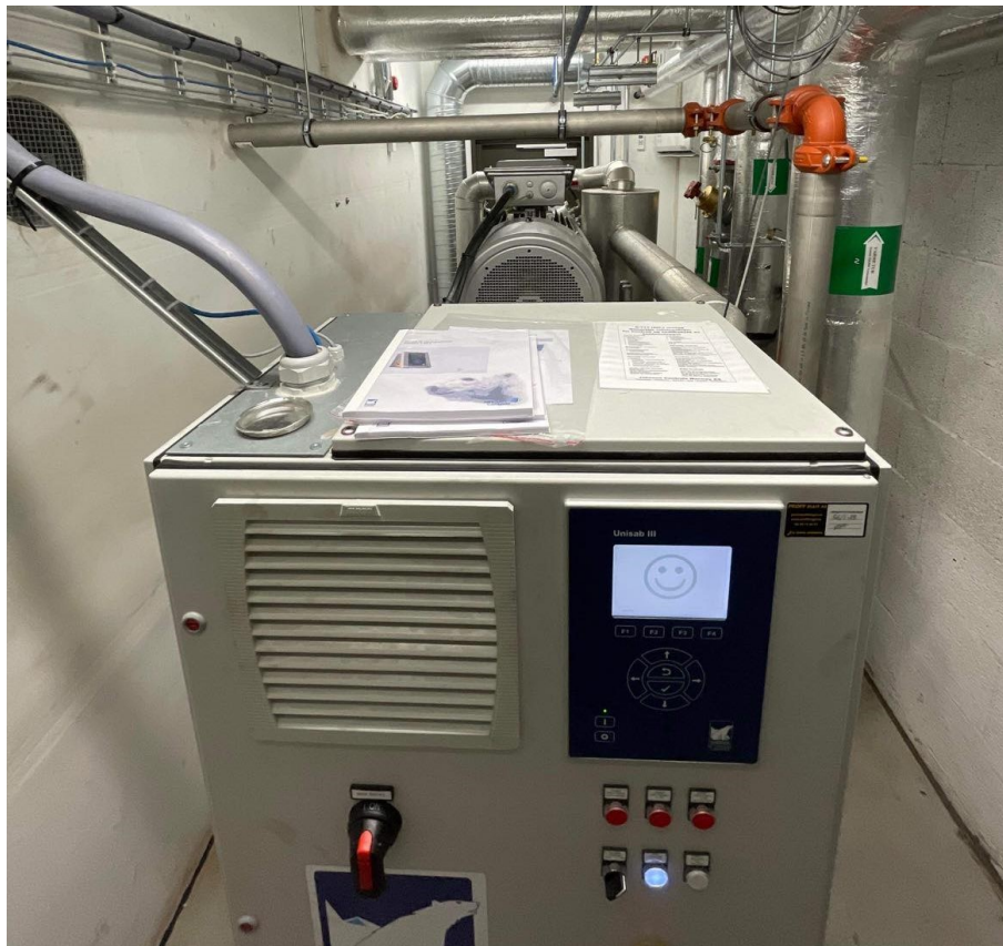
Figur 6: Varmepumpa på Orklandbadet
