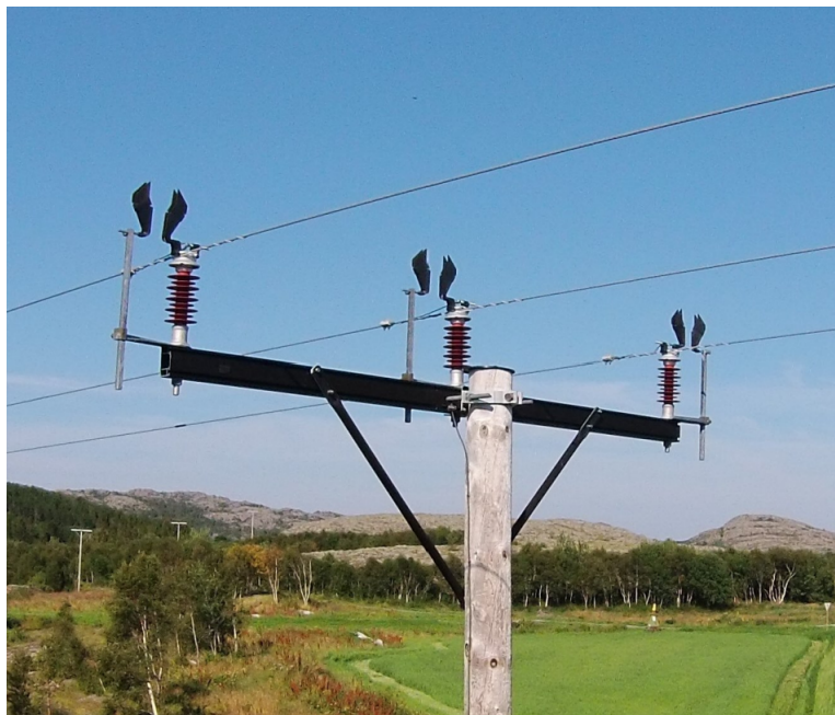
Figur 2.16: Gnistgap montert på toppen av en 22 kV høyspentmast [7]
