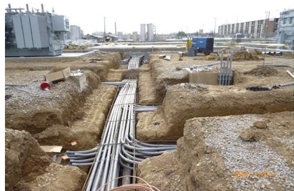
Figur 2.10: Underjordiske høyspentkabler. Hentet fra: Electrical India [4]
