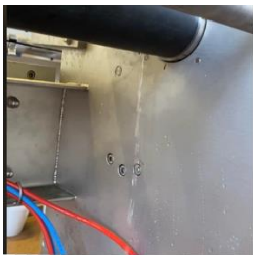
Figur 24: Lekkasje mellom stempel og rotor.
