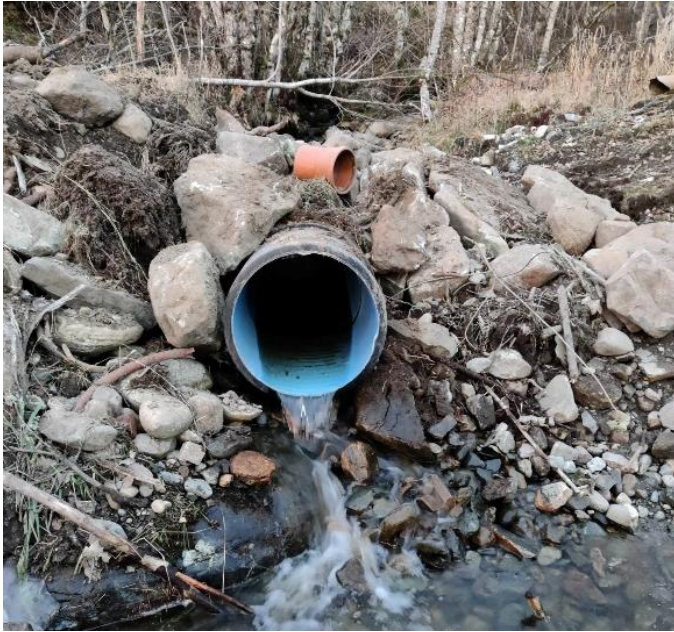
Figur 3 Klassisk eksempel på symbolet «menneskeskapt vandringshinder» i form av kulvert. Kulvertar må vere store nok til at dei ikkje tettar seg, ha liten hellingsgrad og ikkje plassert for høgt som denne. Dersom kulverten oppfyller desse krava går den under symbol «lukka løp».
