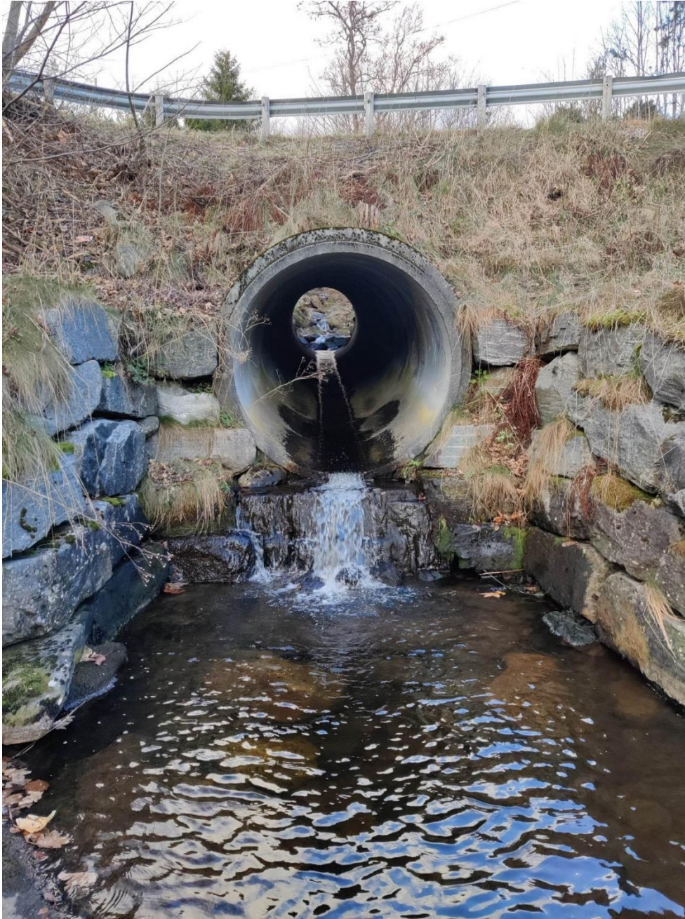
Wensellelva på Sjøholt: Kanalisering (utretting), forbygging (bekk er gjort smalare), manglande kantvegetasjon (skjul) og for bratt kulvert for sjøørret på gytevandring.
