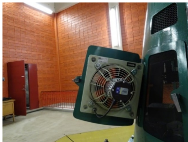
Figur 5.1.5: Bilde av avtrekkssystem generator på Sokna (Eget bilde av forfatter, 2023).
