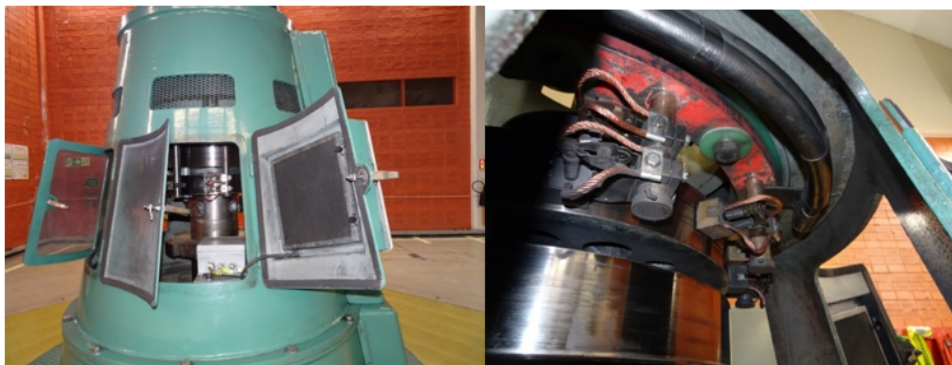
Figur 5.1.3: Bilder tatt av generator på Sokna vannkraftverk (2023).
