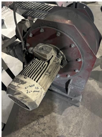
Figur 15: Sperreluftvifte i drift.
