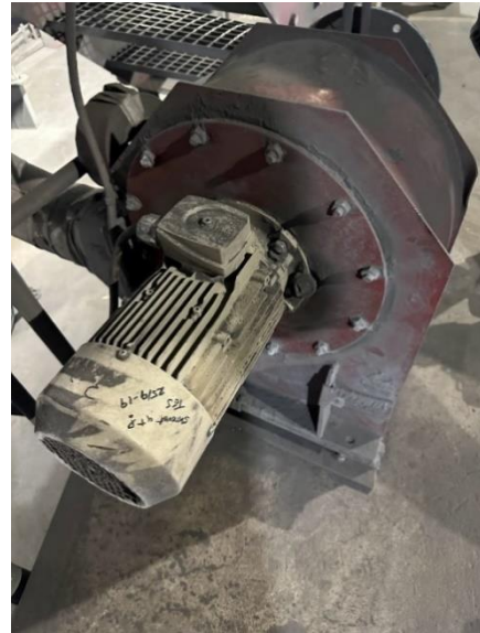
Figur 12: Hele systemet, noe som inkluderer viften, viftehuset som er spiralformet, el-motor, luftinntak og rør
